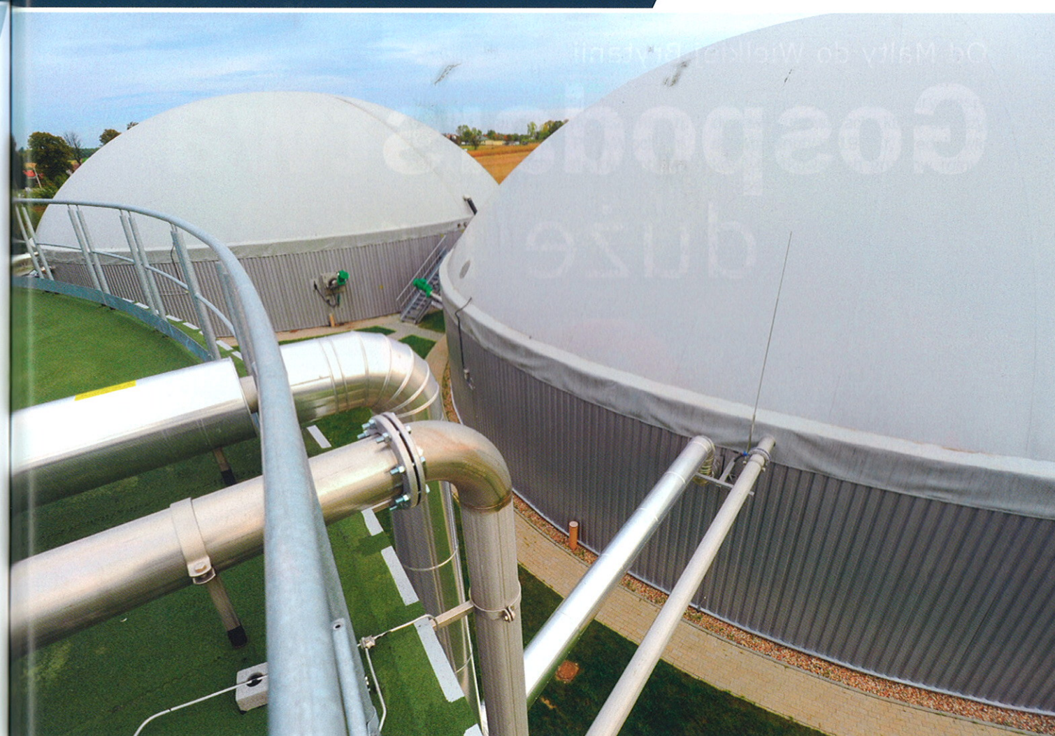
Biogazownia w Konopnicy o mocy niespełna 2 MW kosztowała 30 mln zł. Ponad połowa tej kwoty pochodziła z unijnej dotacji
